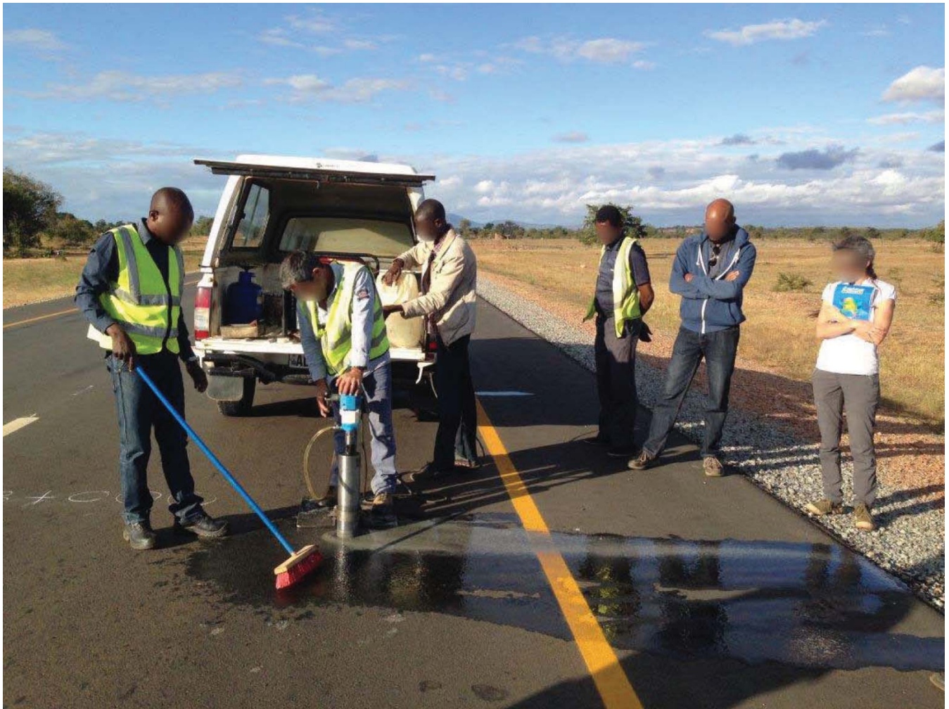
Illustration 3 — Prüfung der Genauigkeit der Messung der Asphaltdeckenstärke einer Straße, für die im Rahmen eines Straßenbauprojekts in Sambia eine Zahlung geleistet wurde
